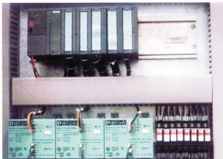
Aplicação de Fontes de Alimentação, já protegidas com os Protetores Contra Sobretensões - TRABTECH.
